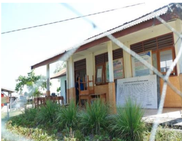
Gambar 2 Kondisi Perpustakaan SD Negeri 29 Manggar Pulau Buku Limau sebelum diremajakan
